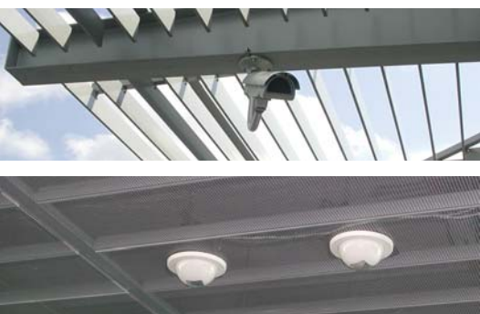
Meer dan 100 camera's, aangesloten op het toegangscontrolesysteem.
